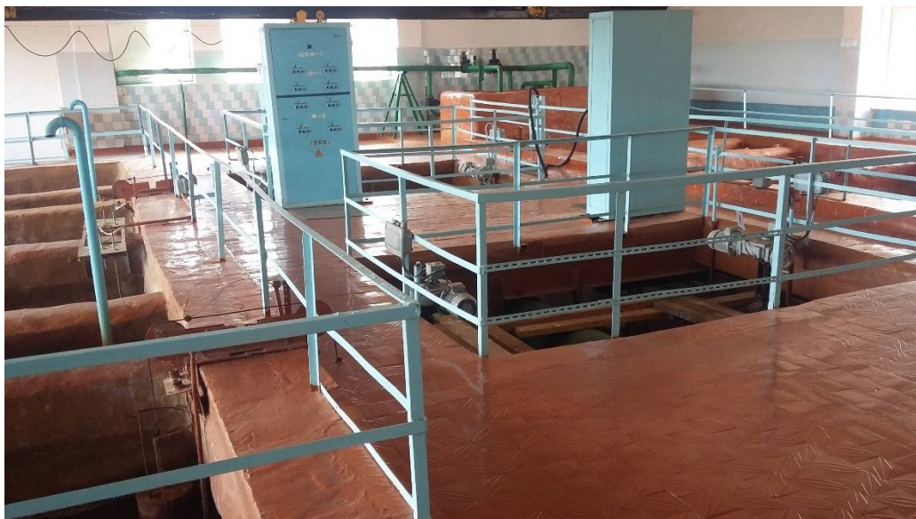
Рисунок 1.12 – Общий вид блока фильтров станции очистки водозабора Столбовский
