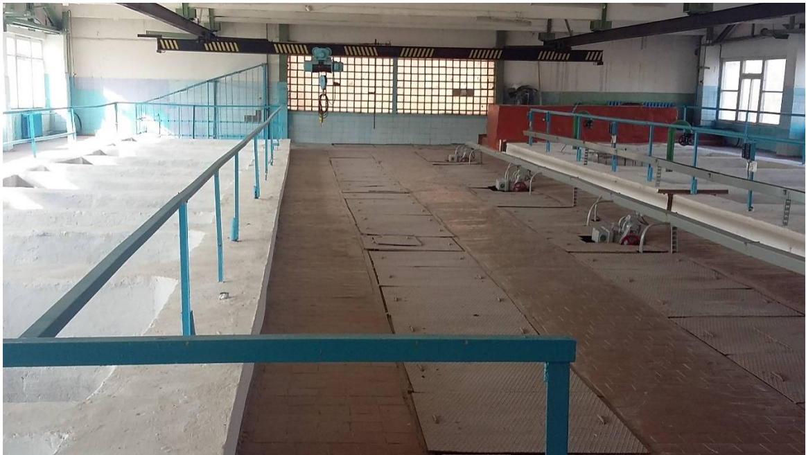
Рисунок 1.13 – Общий вид блока фильтров станции очистки водозабора Верхне-Гжатский
