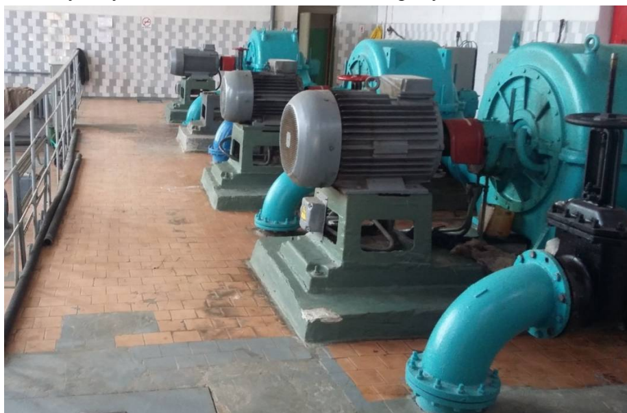
Рисунок 1.3 – Машинное отделение канализационных очистных сооружений с установленными воздуходувками ТВ-80-1,4
