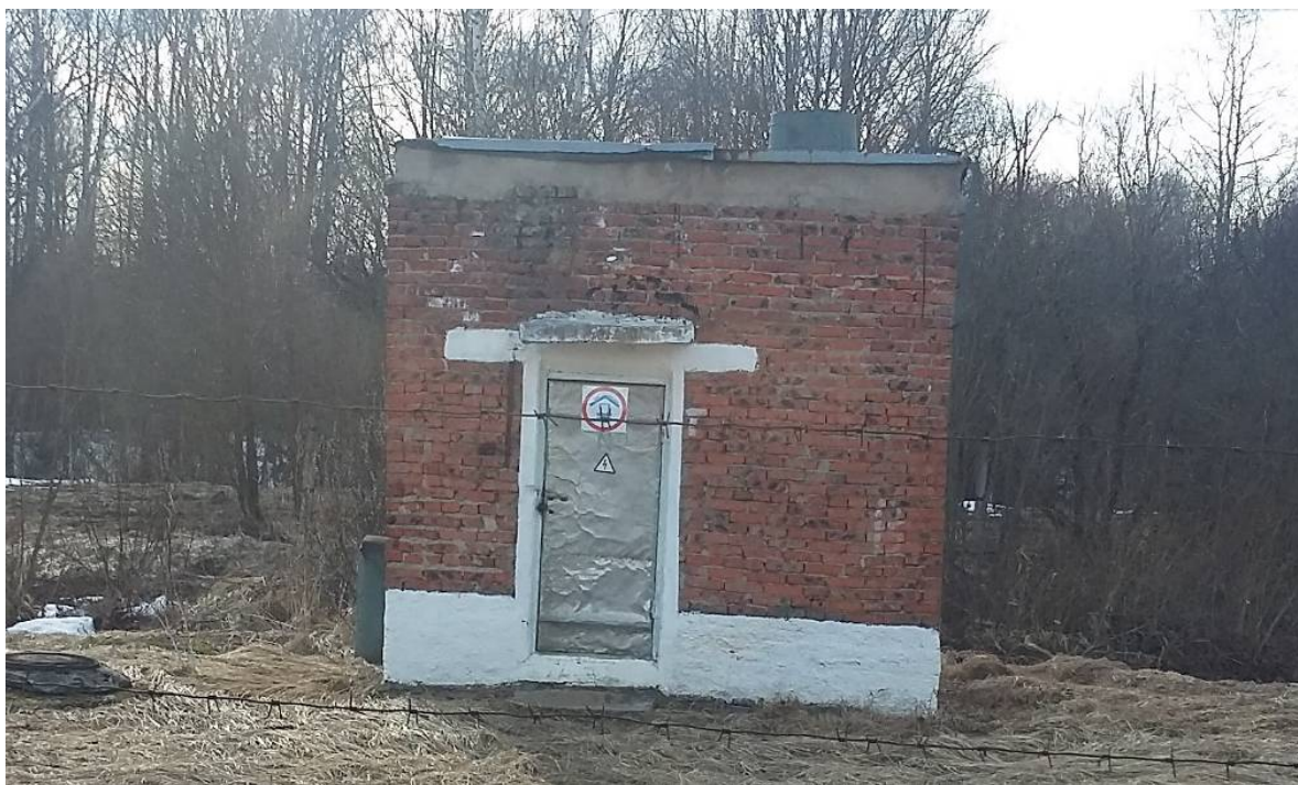
Рисунок 1.6 – Общий вид 1 павильона скважины водозабора Верхне-Гжатский
