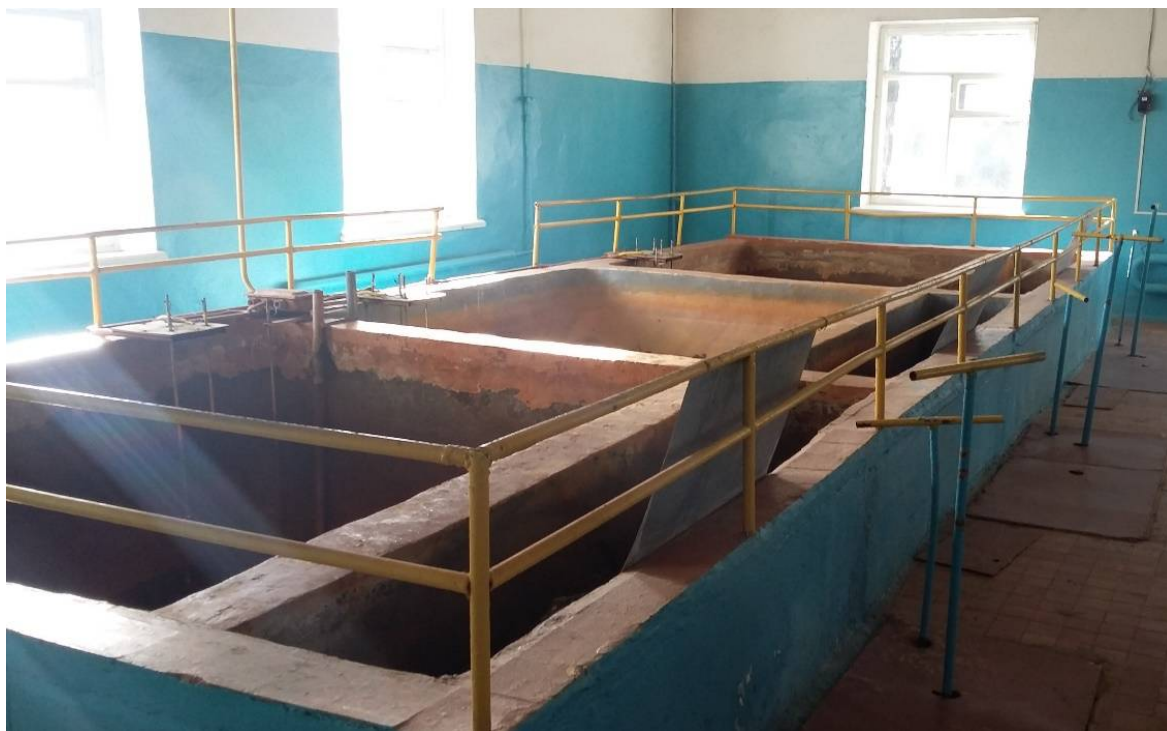
Рисунок 1.11 – Общий вид одной из секций блока фильтров станции очистки водозабора Центральный
