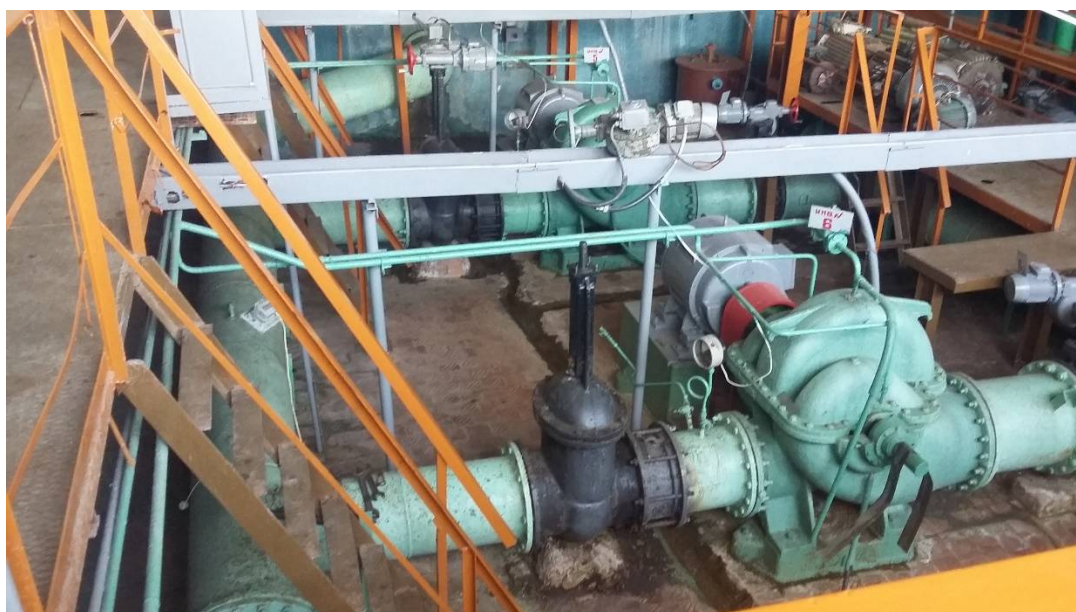
Рисунок 1.29 – Общий вид машинного отделения насосной станции второго подъема водозабора Столбовский
