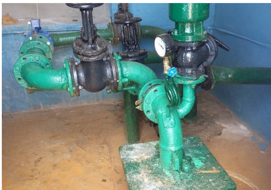
Рисунок 1.4 – Общий вид обвязки трубопроводами вывода артезианской скважины №7 водозабора Столбовский
