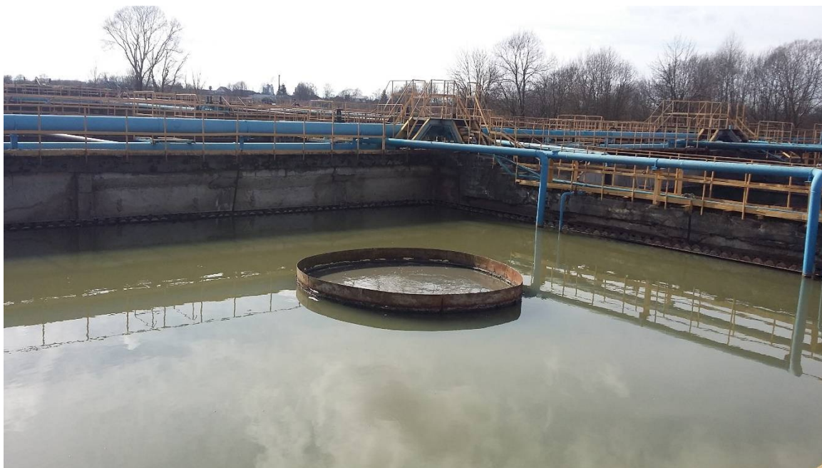
Рисунок 1.2 – Двухкоридорный аэротенк, установленный на канализационных очистных сооружениях
