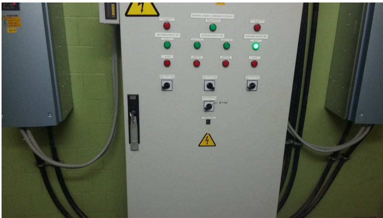
Рисунок 4.1 – Щит управления, установленный на КНС-5
